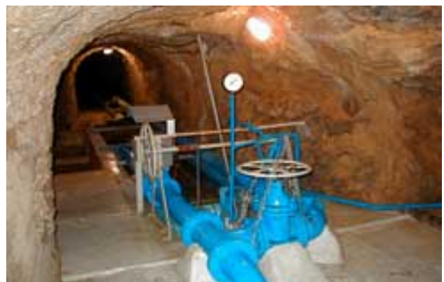
Fig. 7-31: Stollen zur Quellfassung, Karst-Grundwasserleiter (Source de la galerie des Moyats, Quelle der Stadt La Chaux-de-Fonds, NE).
